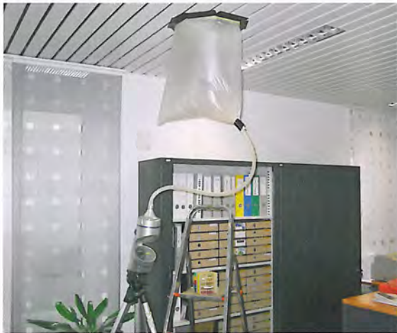
Messung der Zuluft im Büro: Seit 2009 können auch bestehende Gebäude zertifiziert werden.
